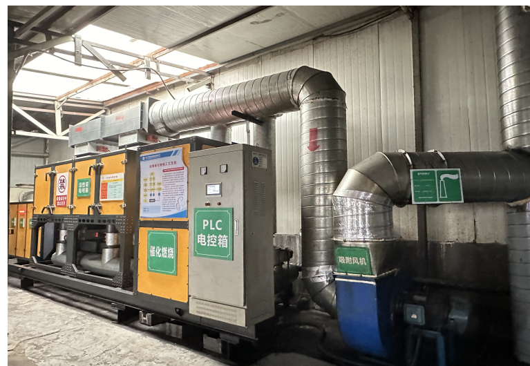
活性炭吸附脱附+催化燃烧装置
